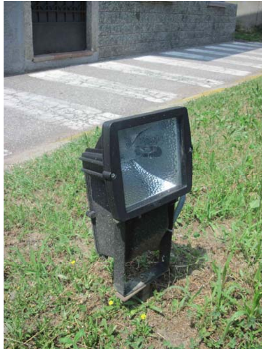
Proiettore per l'illuminazione d'accento del Monumento collocato in Piazza Cavour
