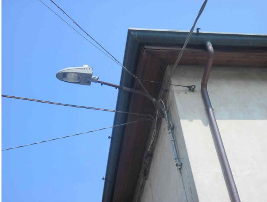
Via Roncaccio: giunzioni di cavi su facciata
