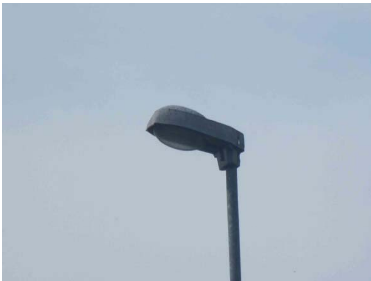
Via Roma: armatura stradale dotata di vetro di chiusura diffondente del tipo "a coppa" non compatibile con le vigenti norme regionali.
