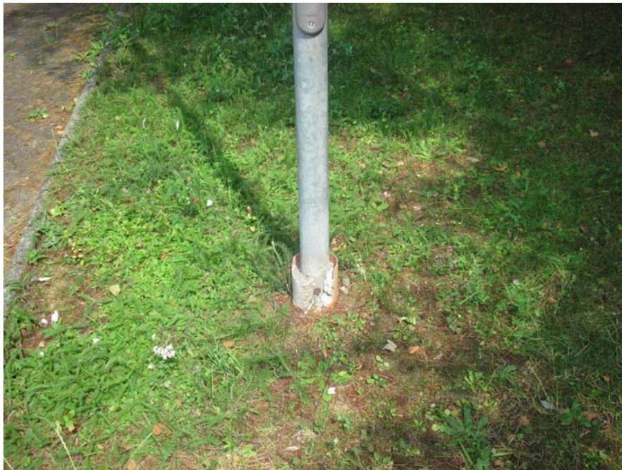
Parco comunale "Pissina": sostegno con collarino danneggiato
