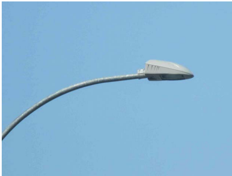
Via Carducci: armatura stradale totalmente schermata dotata di vetro di chiusura piano conforme alla L.R.17/200 e s.m.i..
