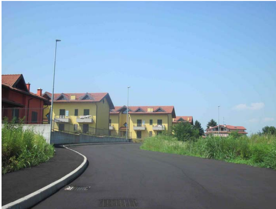
Via Dante Alighieri: impianto di recente realizzazione costituito da apparecchi stradali totalmente schermati equipaggiati con lampade ai vapori di sodio ad alta pressione ed installati su palo in acciaio zincato, con linea di alimentazione interrata.
