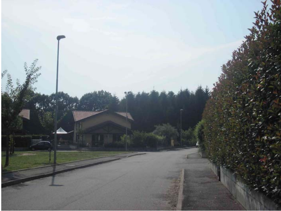
Via S. Ambrogio: impianto di recente realizzazione costituito da armature stradali totalmente schermate dotate di sorgenti ai vapori di sodio ad alta pressione ed installate su palo in acciaio zincato, con linea di alimentazione interrata.
