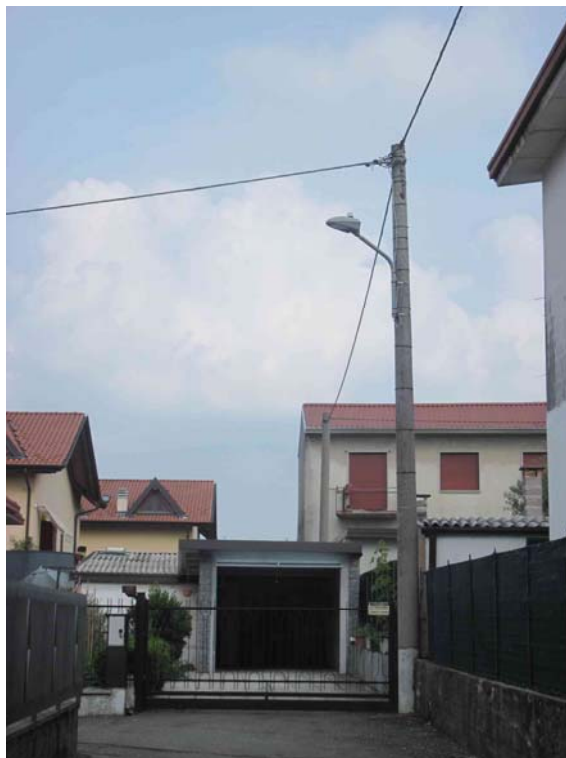
Via Leopardi: giunzioni di cavi su sostegno in c.a.c.
