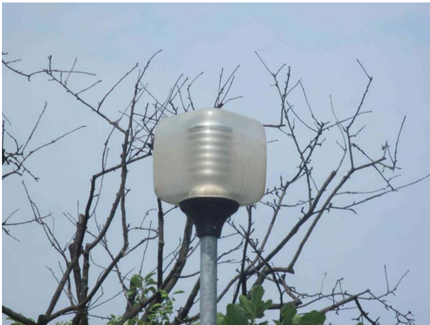
Apparecchio di arredo urbano di tipo diffondente non conforme alla L.R. 17/2000 e s.m.i., installato nel Parco pubblico "Pissina, nel parcheggio di Via Monaci e lungo il percorso pedonale che lo collega con Via Pellico
