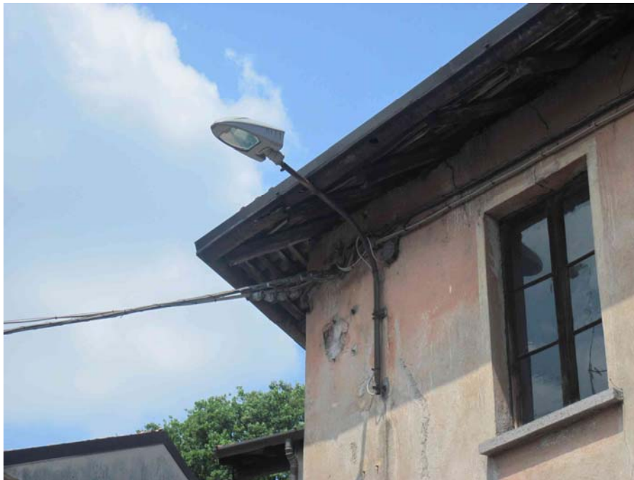
Via Martignoni: giunzioni di cavi su facciata
