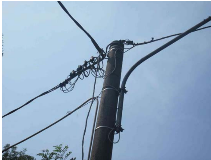
S.P. 49: giunzioni di cavi su sostegno in c.a.c.
