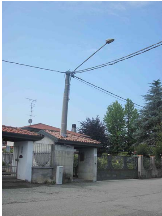
Via Carducci: il palo in c.a.c., interno ad una proprietà privata, attraversa la copertura del cancello di ingresso.
