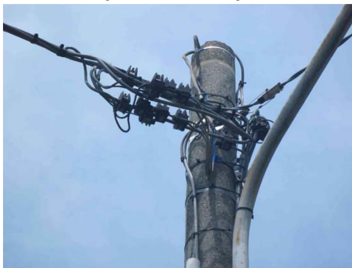
Corso Milano: giunzioni di cavi su sostegno in c.a.c.
