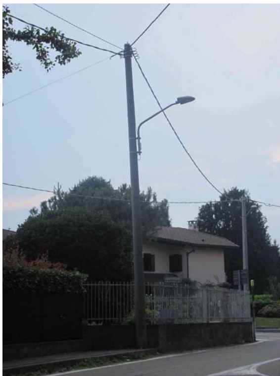
Via Roma: giunzioni di cavi su sostegno in c.a.c.
