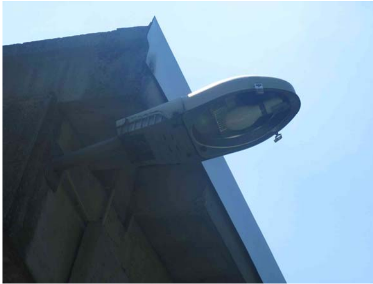
Magazzino comunale di Via del Tornago: armatura stradale che ha perso il vetro di chiusura non conforme alla L.R.17/200 e s.m.i.
