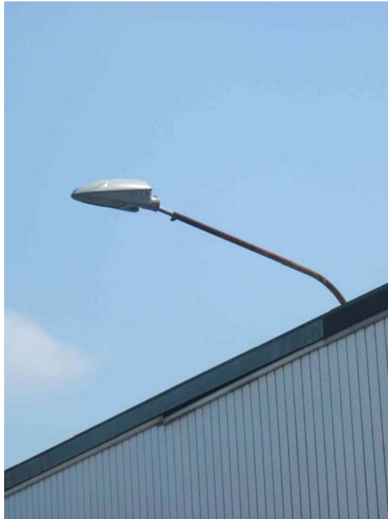
Via Marconi: sostegno a mensola arrugginito
